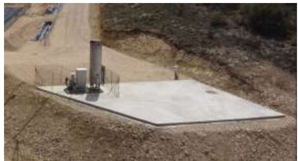
Torchère et dalle béton
