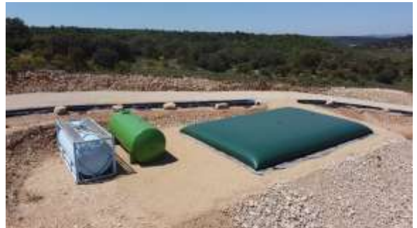
Cuves stockage et citerne incendie
