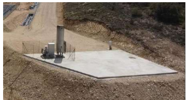
Torchère et dalle béton
