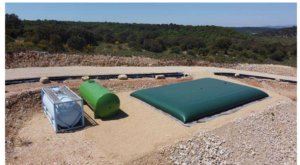
Cuves stockage et citerne incendie
