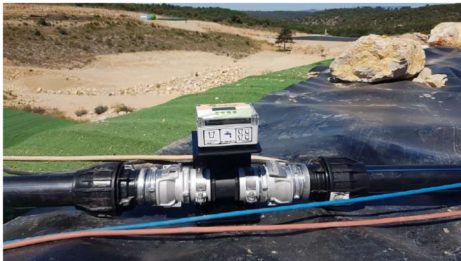
Compteur volumétrique de l'alvéole 1 du casier n°4
